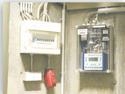
Fernabfrageeinheit im Wasserturm
